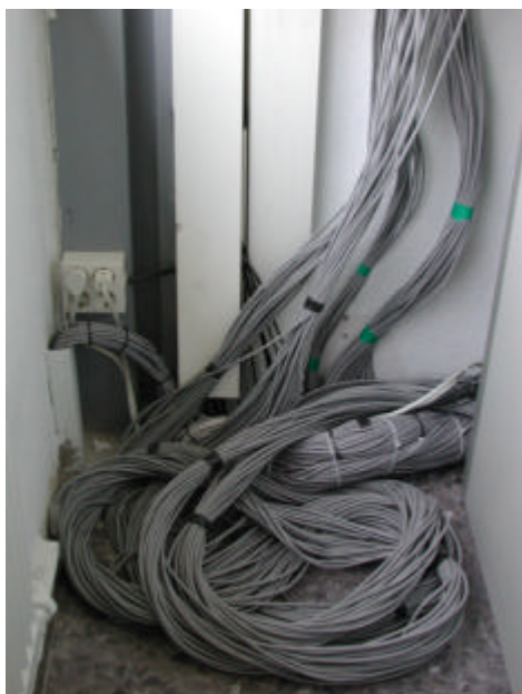
Figura 3: Detalle del cableado
