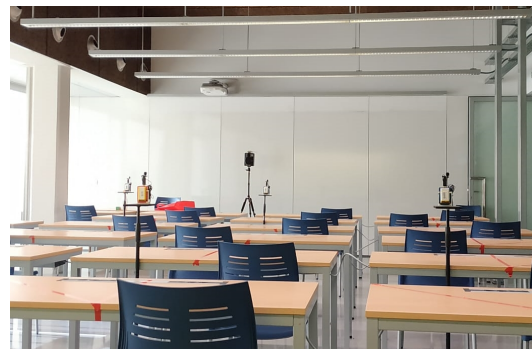
Figura 3: Sistema IoT instalado en un aula.
